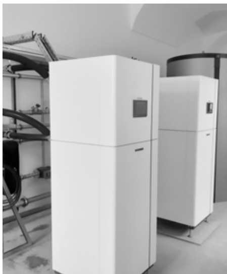
Die Wärmepumpen im Meierhof
